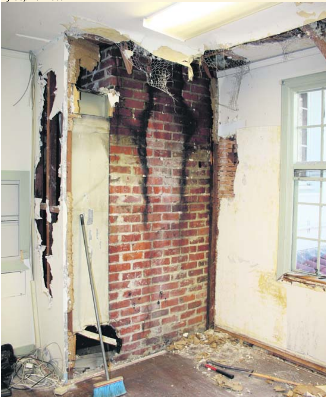
Fire damage to the Hacienda de las Flores Photo Dana Blatner
